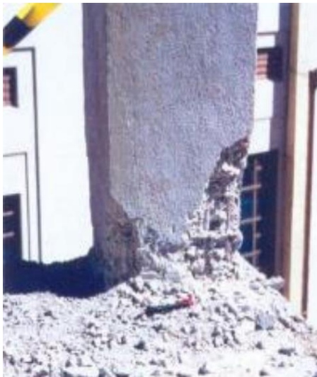
Figura 5 – Vão de concreto em parte inferior de pilar. Fonte: Figuerola (2006).
