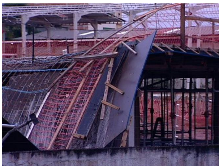
Figura 7 – Problema com laje causado por falhas no planejamento e/ou na execução do escoramento. Fonte: Trindade (2015).
